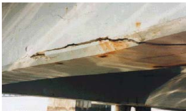
Foto 1. Keretakan balok akibat korosi (KATRI, 2002)
