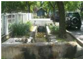
Gambar 4.13 Penanganan di depan tapak rumah tinggal dan mantan tempat usaha CV. Jajadi
