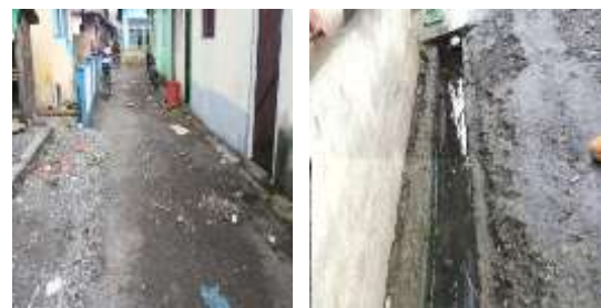
Gbr 1. Kondisi eksisting drainase
