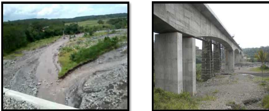
Gambar 1. Kondisi lokasi sungai Bumiayu dengan pola aliran debris.
