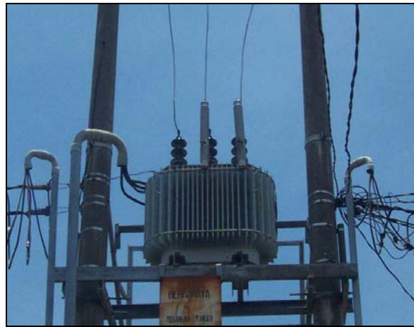
Gambar 2. Trafo Distribusi 200 kVA
