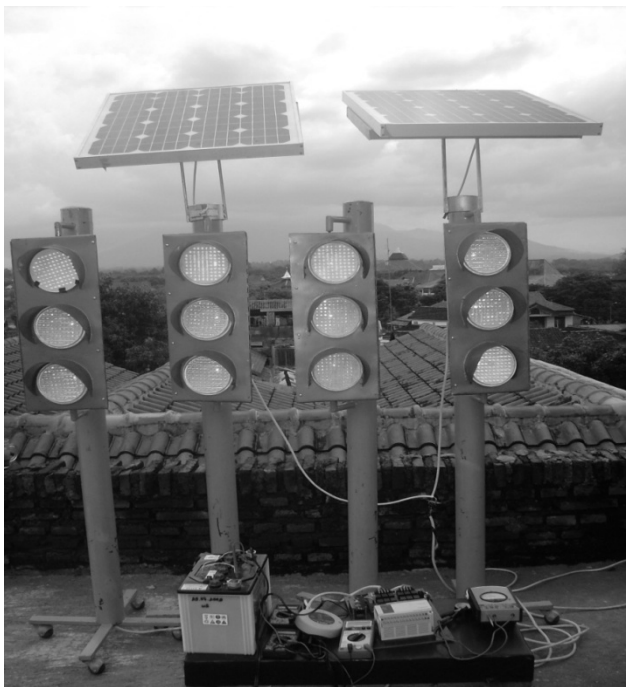
Gambar 4. Realisasi Pemberdayaan Energi Surya Pada Lampu Lalu Lintas
