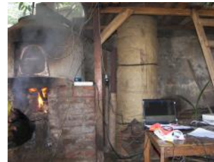
Gambar 1. Penempatan sensor temperatur di ruang pemanas dan di pipa uap
