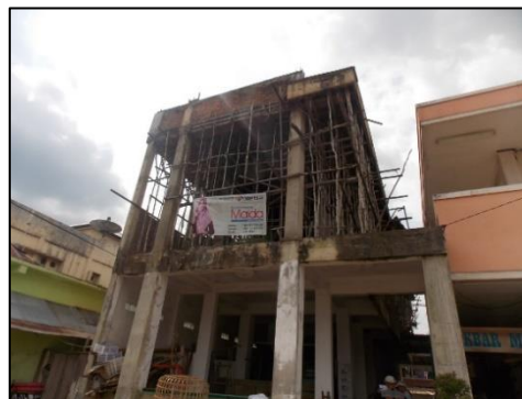
Gambar 5. Kondisi Bangunan pasar Tanjung
