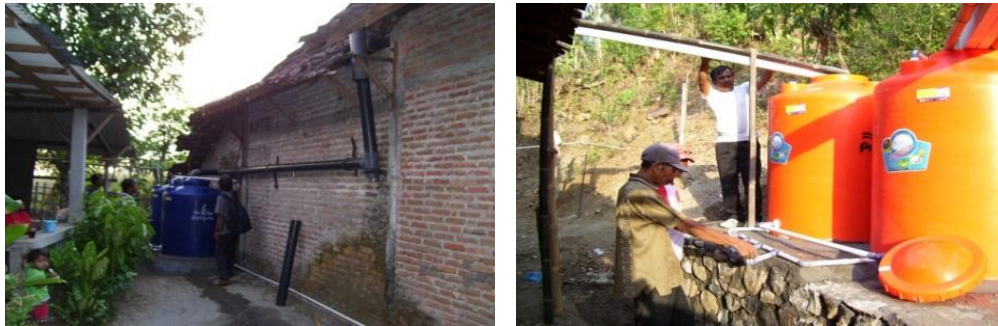
Gambar 2. Model bangunan panen hujan melalui atap rumah di Dusun Lemah Rubuh, Desa Selopamioro, Kecamatan Imogiri, Kabupaten Bantul, DI Yogyakarta untuk keperluan rumah tangga
