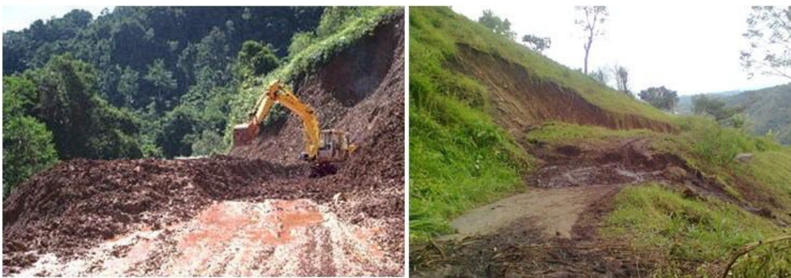
Gambar 4. Tanah longsor dangkal merusak beberapa jaringan transportasi di Sulawesi Selatan.
