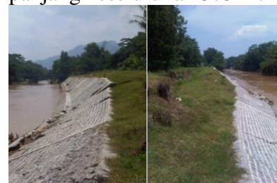
Gambar 8. Kondisi dinding penahan eksisting melalui peninjauan lapangan
