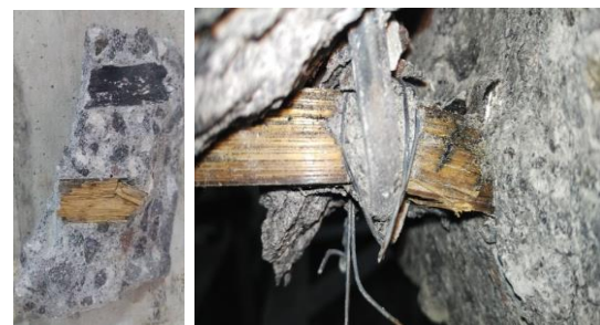
Gambar 12. Keruntuhan lekatan pada balok.
