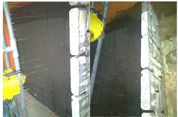
Gambar 10. Keretakan dan kelongsoran pasir yang terjadi pada sisi atas dinding.
