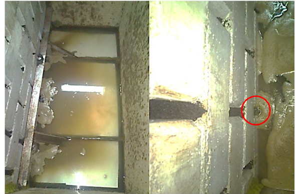
Gambar 9. Pasir yang terbawa air keluar dari celah dinding.
