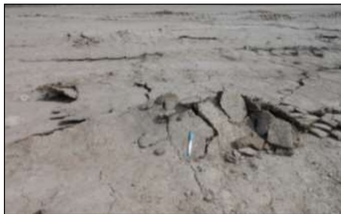
Gambar 1. Ketinggian Gelombang dan Kerusakan Jalan Angkut
